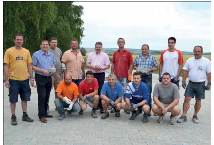
Parkplatz gepflastert: In Altruppersdorf wurde der Parkplatz vor dem Sportplatz gepflastert. Die Pflasterarbeiten wurden von zahlreichen freiwilligen Helfern übernommen. Bürgermeister Thomas Griebel und Vizebürgermeister Herbert Bauer dankten für den großartigen Einsatz.
